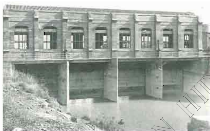
Compuertas de la Presa del Gállego
