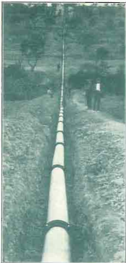
CONDUCCIÓN DE AGUAS EN CERVERA (LHMA) 1065 metros longitud. - 250 mm diámetro - 10 atmósferas
